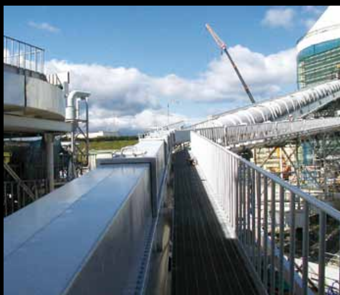
▲粉体輸送設備(エアスライドコンベア)
