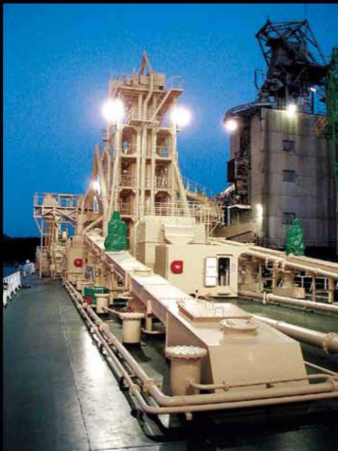
▲粉体輸送設備(エアスライドコンベア・バケットエレベーター)
