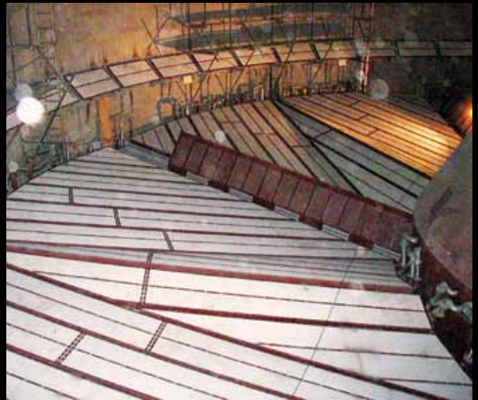
▲セメント・フライアッシュ エアレーションシステム(サイロ内部)
