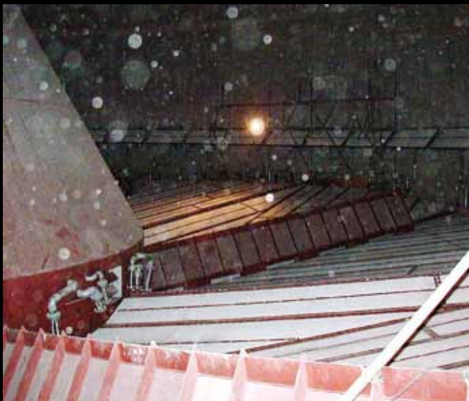
▲セメント・フライアッシュ エアレーションシステム(サイロ内部)
